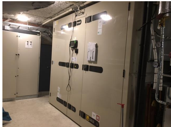
Bilde 8. Rådhuset, nytt hoved-ventilasjonsaggregat med integrert kjøling.
