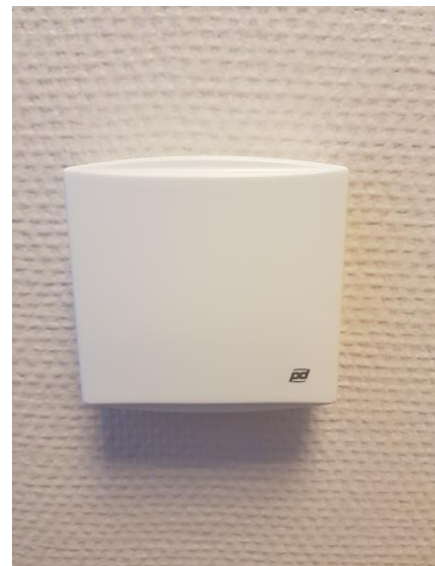
Bilde 5. Styreenhet-termostat til varmeovner. Foto: Rindal kommune
