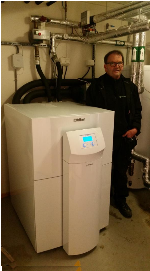
Bilde 14. Varmepumpe jord til vann, Kveldheim eldreboliger.
